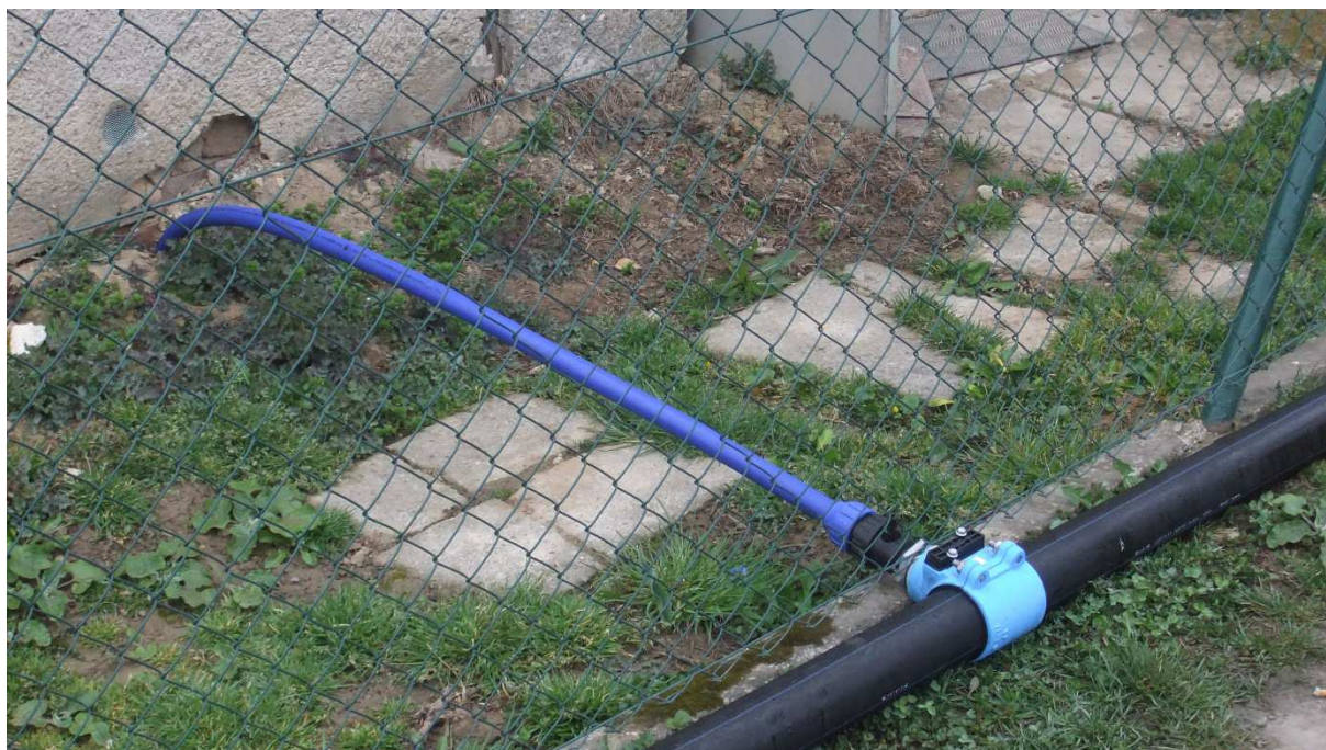
Obr. č. 4 Náhradní nebo nouzová dodávka vody prostřednictvím suchovodu [foto autor]
