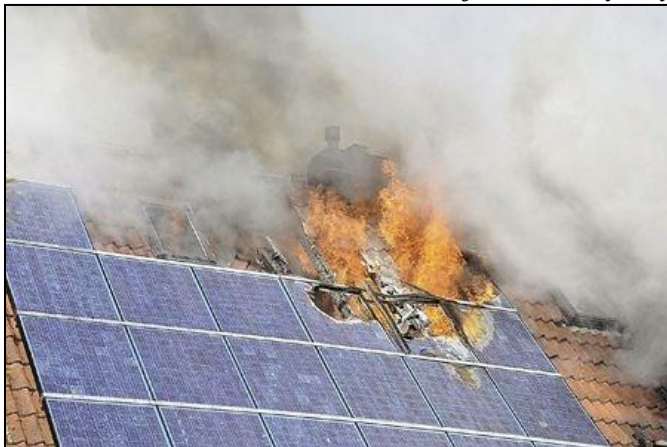
Zdroj: Jensys Power Technology Co., 2019.
